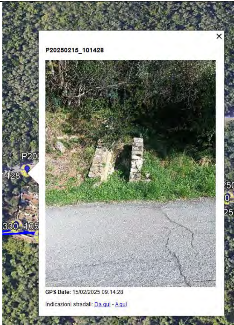
Scarico a monte lungo SP 38 probabilmente ostruito
